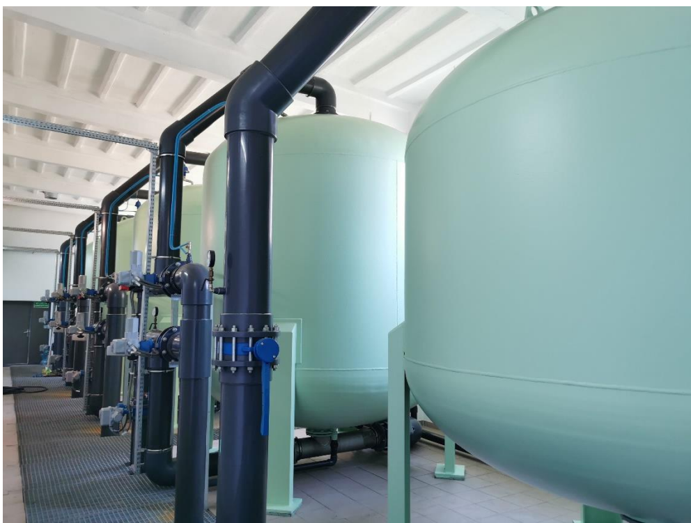
Hala Filtrów SUW Kąty Wrocławskie
