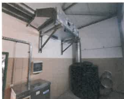
Fot. Filtr węglowy stosowany do eliminacji zjawiska korozji siarkowodorowej na oczyszczalni ścieków w Jurczycach.
