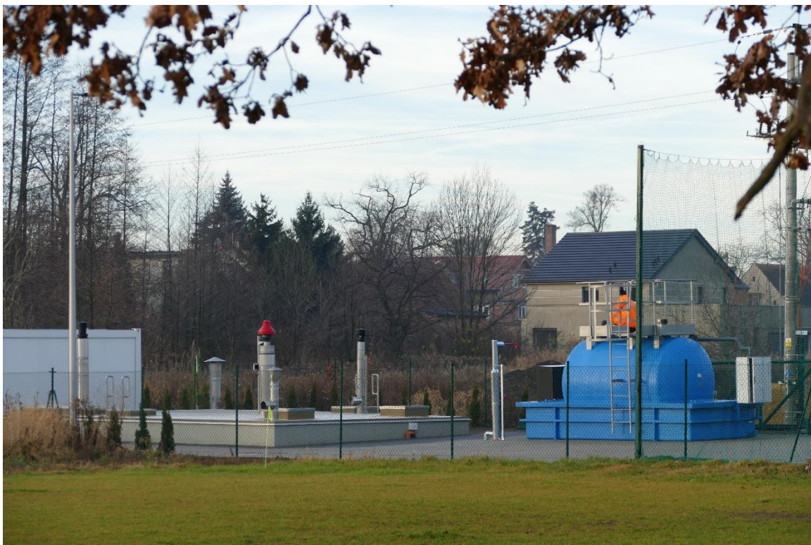
Zmodernizowana przepompownia w Smolcu
